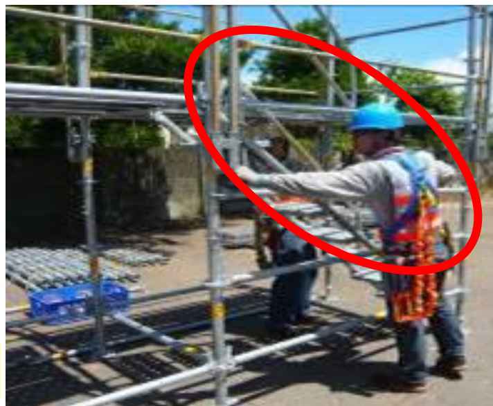
樓梯扶手設於施工架外側
